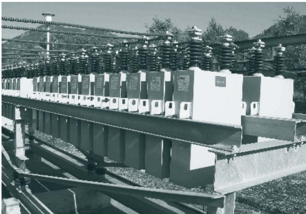
Podnapis pod fotografijo: Filtrska kompenzacija s KLV-kondenzatorji, Acroni, Jesenice
